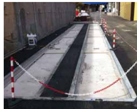
Esempio di installazione in piazzale asfaltato
